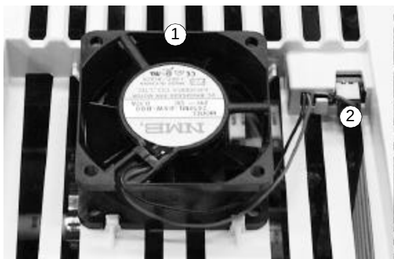
拆下前盖, 风机顶部。
